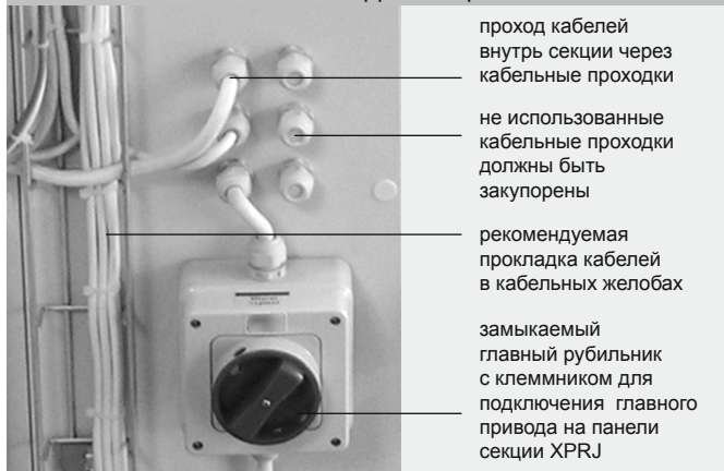
Рис. 4 – кабельные выходы секции
